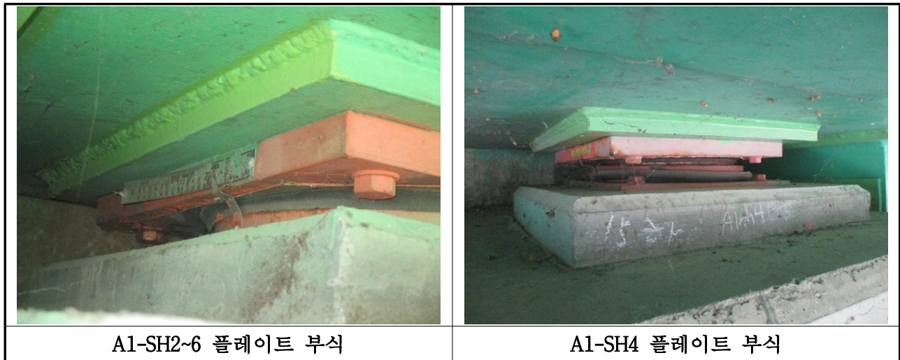
【사진 7.1】 신축이음 누수에 따른 손상 발생 현황
